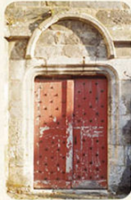
Figura 4.24. Los efectos de la lluvia ácida pueden observarse en el deterioro de las edificaciones.
